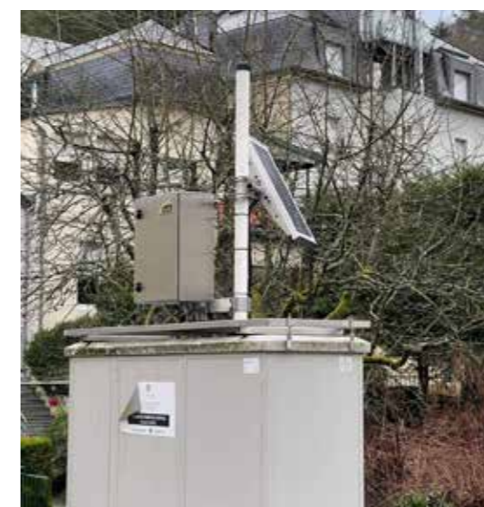
Installation solaire pour alimenter l'hydromètre
